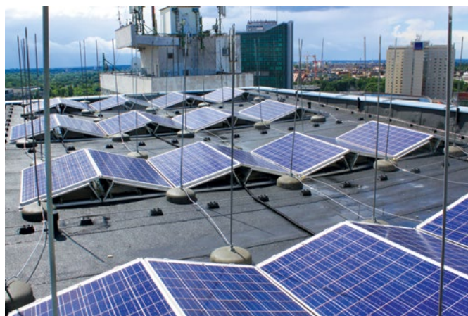
Rys. 18. Przyklad blednie wykonanej ochrony odgromowej Instalacji PV – niezachowanie odstepow separujacych elementow LPS od paneli oraz rozmieszczenie zwodow pionowych w sposob zaciemniajacy panele
