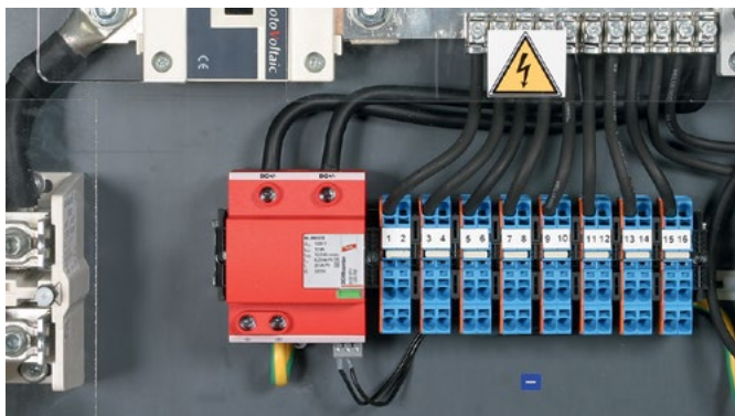
Rys. 32. Przykład montażu ograniczników przepięć typu 1 chroniących instalację PV b) ogranicznik przepięć typu 1 w skrzynce przyłączeniowej paneli (DC)
